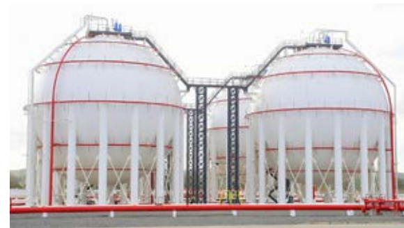
Ujenzi wa kampuni ya kisasa ya LPG ya Lake Gas huko Vipingo katika hatua zake za mwisho.
